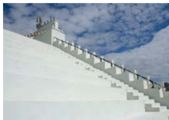
2008 год, Москва. Капитальный ремонт трибун Водного стадиона «Динамо». Гидроизоляционное и защитное покрытие трибун и фасадов покрытием MasterSeal 588 White.
