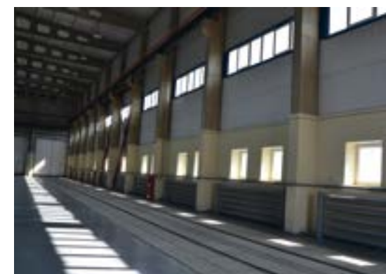
2011 год, Вагонное депо в г. Лабитнанги. Защита стен депо покрытием MasterProtect 320 RAL 1015.
