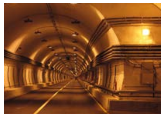
2010 г, р. Дагестан, Гимринский АДТ. Защита свода тоннеля антикарбонизационным покрытием MasterProtect 320 RAL 9010
